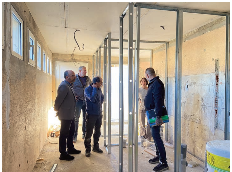
Visite de chantier orchestrée par Marion Blein , architecte du centre de loisirs accompagnée des entreprises et des représentants de la commune
